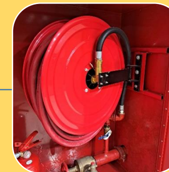
สายฉีดน้ำดับเพลิง
