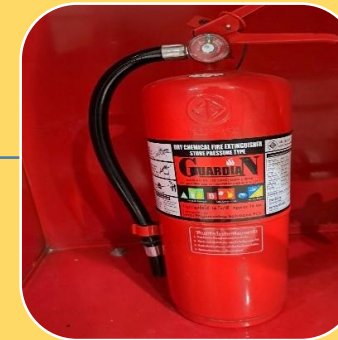
ถังดับเพลิง
