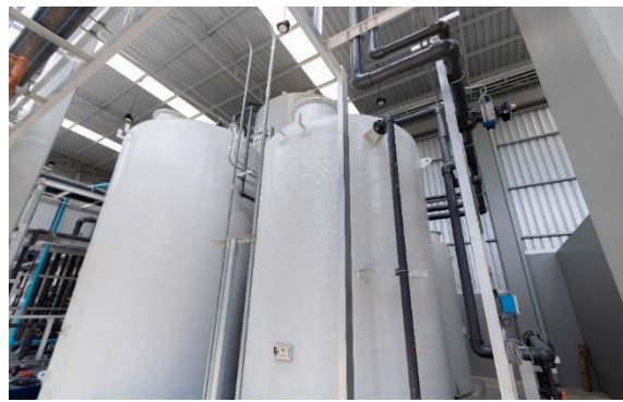
ระบบ Vacuum Evaporator & Pusher Centrifugal
