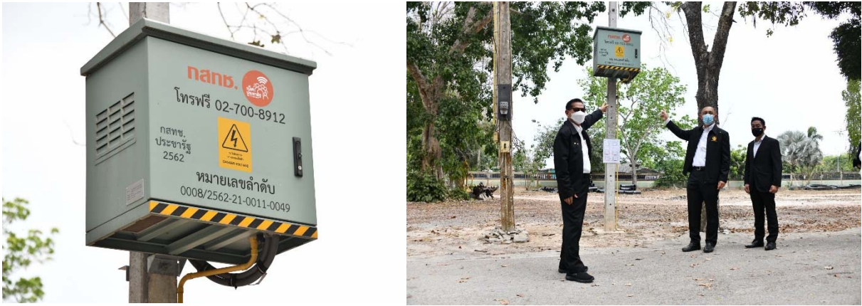
ภาพที่ ๖ ภาพของอุปกรณ์ และจุดติดตั้งโครงการ USO พื้นที่ห่างไกล (Zone C) ณ วัดวังจันทร์ หมู่ ๑ บ้านวังจันทร์ ตำบลวังจันทร์ อำเภอลำลูกกา จังหวัดระยอง
